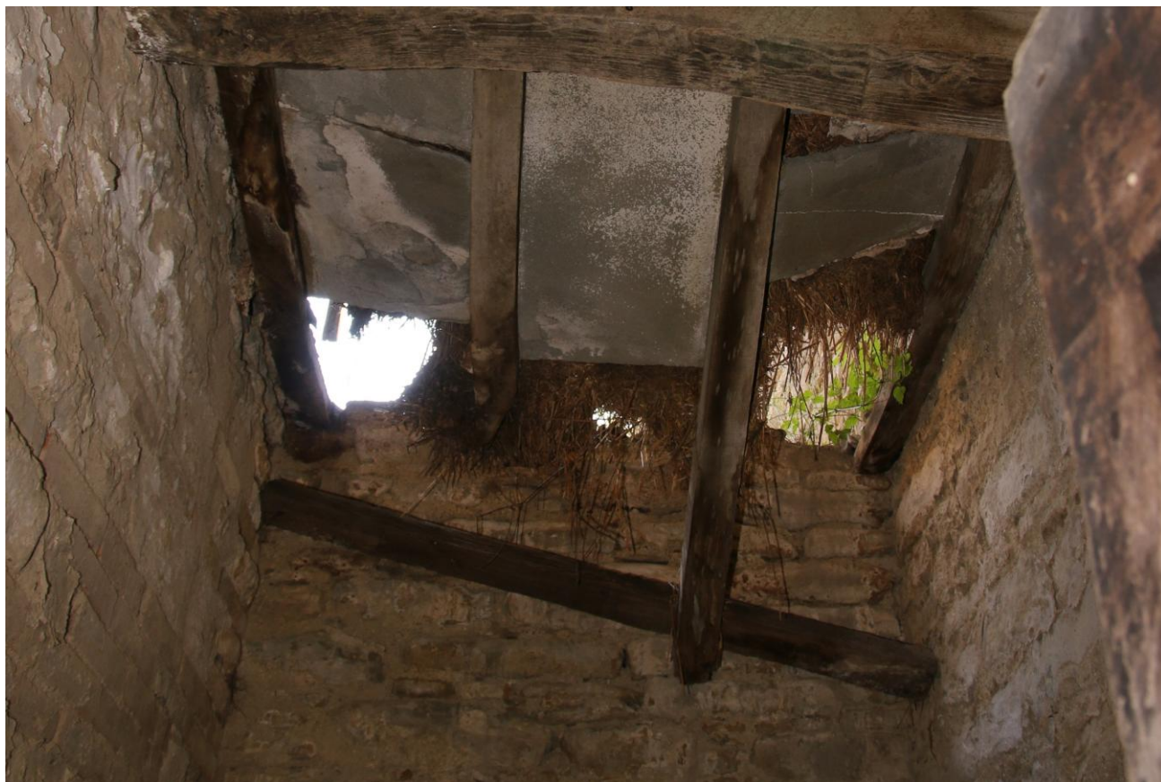
Figura n. 14 – Parte del soffitto crollato nel vano della nursery di R. hipposideros , edificio (Sito n. 12)
